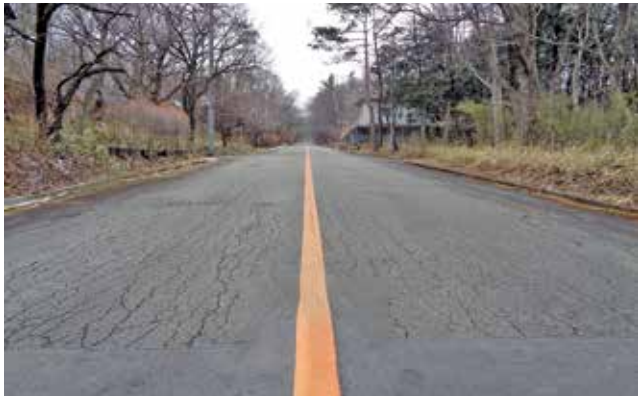
<補修工事前：令和5年1月24日>
